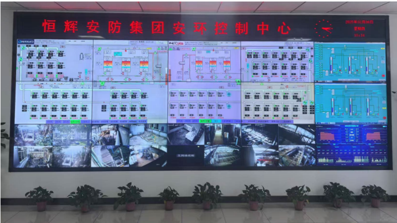
安环控制中心平台
