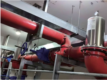
消防泵房水锤整改后
