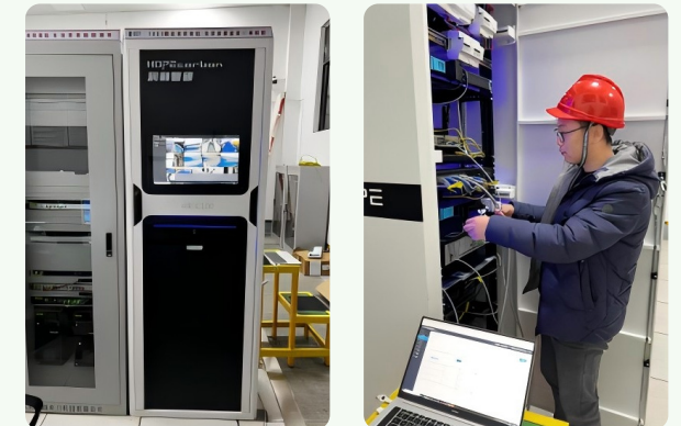
润和软件光伏全景监控一体机落地
