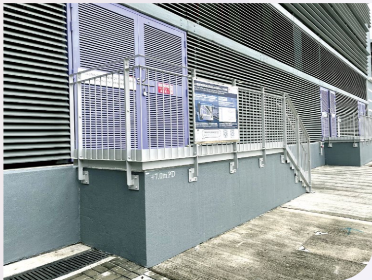
● 港燈的低窪變電站防洪改善工程確保可靠的電力供應。
