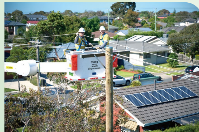
Powercor 正將Ballarat Base Hospital的供電能力提升三倍，並強化當地電網以支援更多家用屋頂太陽能、電動車輛和先進技術。
