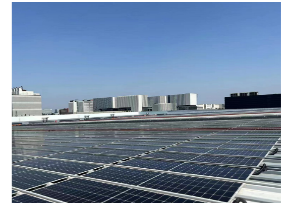
生产基地屋顶光伏
