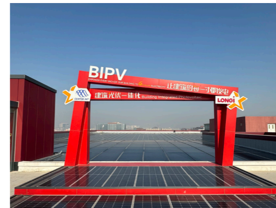
总部办公楼屋顶光伏
