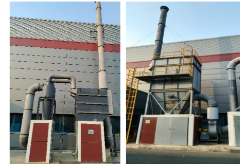
废气处理设备
