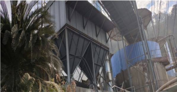
车间内安装的除尘器
