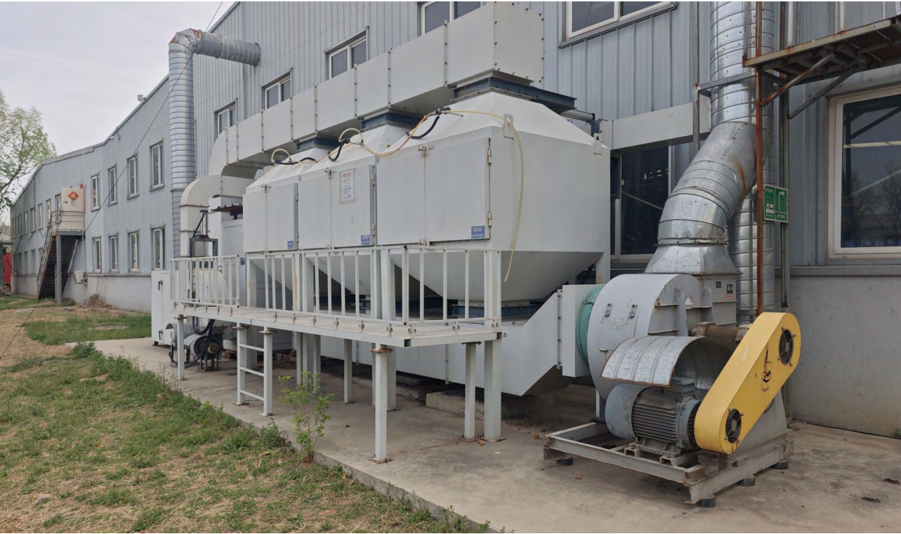
天津工厂 VOCs 处理设备
