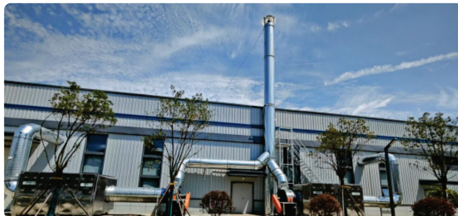
废气处理系统
