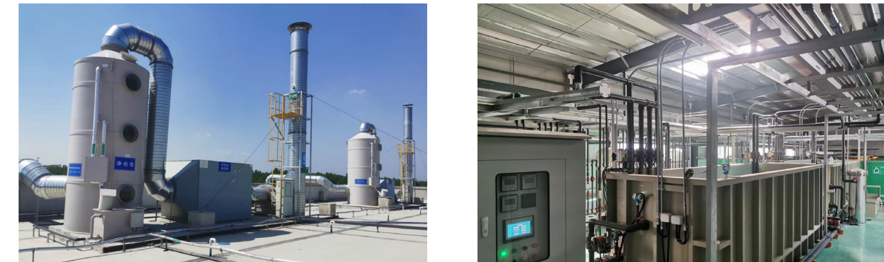
废水在线监测设施
