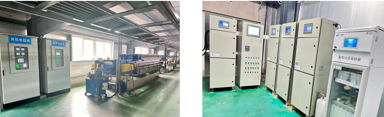
废水在线监测设施
