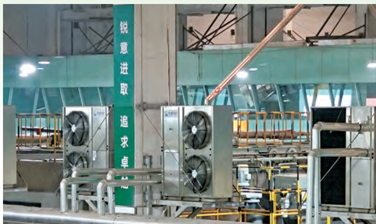
▶ 空氣源熱泵機組
