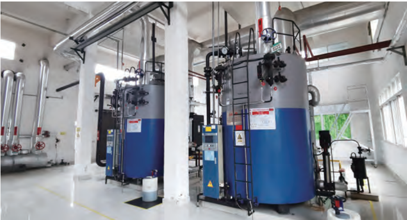
▶ 瀘州公司 4 台燃氣鍋爐全部完成低氮改造
