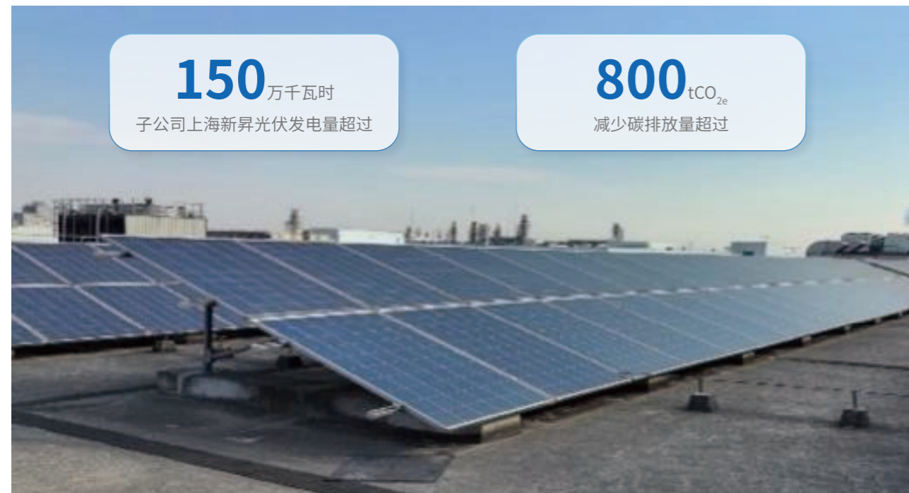
上海新昇光伏系统
