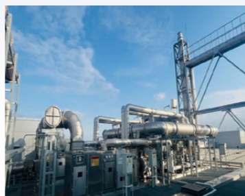
废气处理装置
