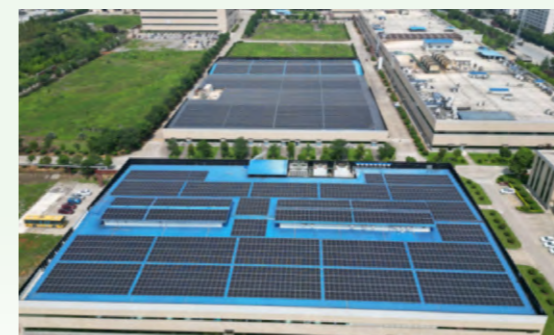
岳阳分公司一期光伏项目
