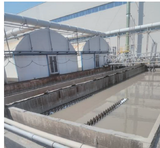
污水处理设施
