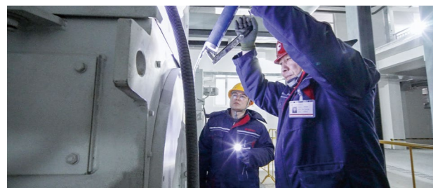
供热设备维护保养
