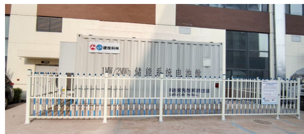
建投科林 2.2MW/4.4MWh 分布式储能及地源热泵设备
