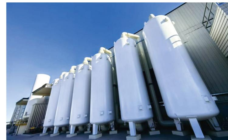
建投储能液态空气储能电站并网试运行成功
