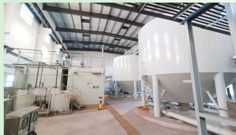
寿阳热电增设工业废水及生活污水处理装置
