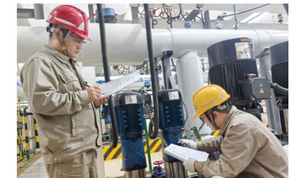
遵化热网热网巡检技能比武
