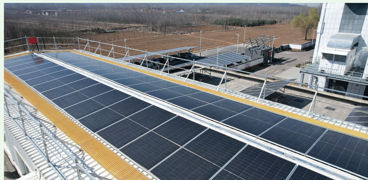
遵化热电 1.47MW 厂区光伏年发电量约 170 万度
