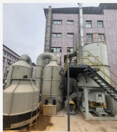
● RTO废气处理以及氨气处理设备
