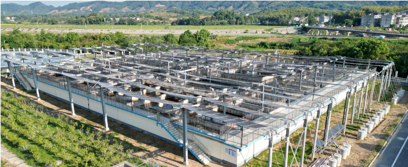
瑞昌光伏项目现场
