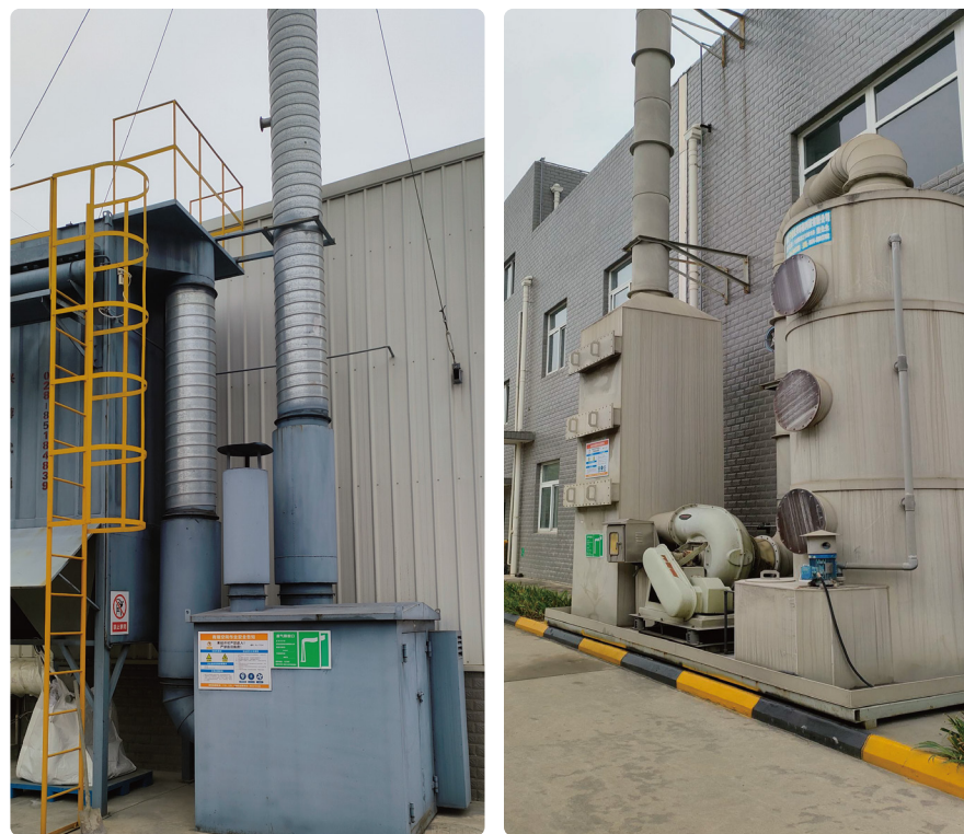
碳化硅除尘设备、尾气处理设备
