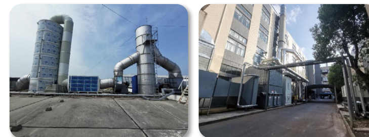
▲ 正在工作的废气处理设备
