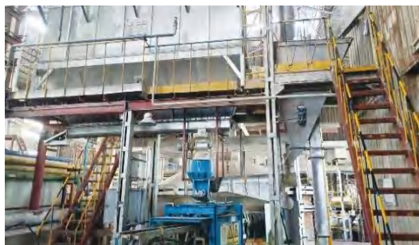
电炉袋式除尘器
