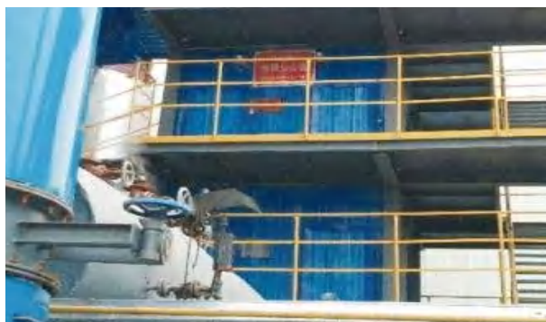
燃气窑炉除尘器及SCR脱硝器
