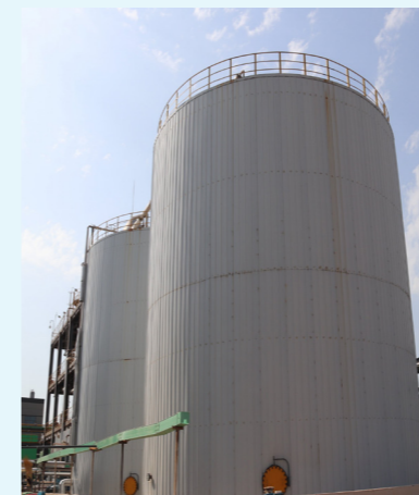
车间废水暂存罐
