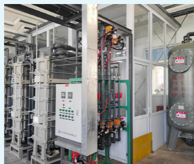
公司潍坊西厂区 电渗析升级改造
