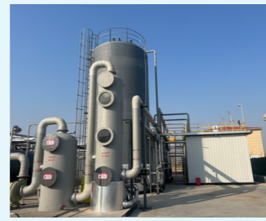
青岛润农 车间VOC尾气处理改善项目
