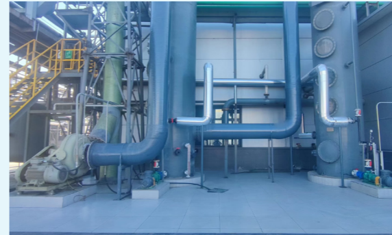
三酮车间废气处理设施
