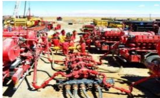
油田压裂系统装置
