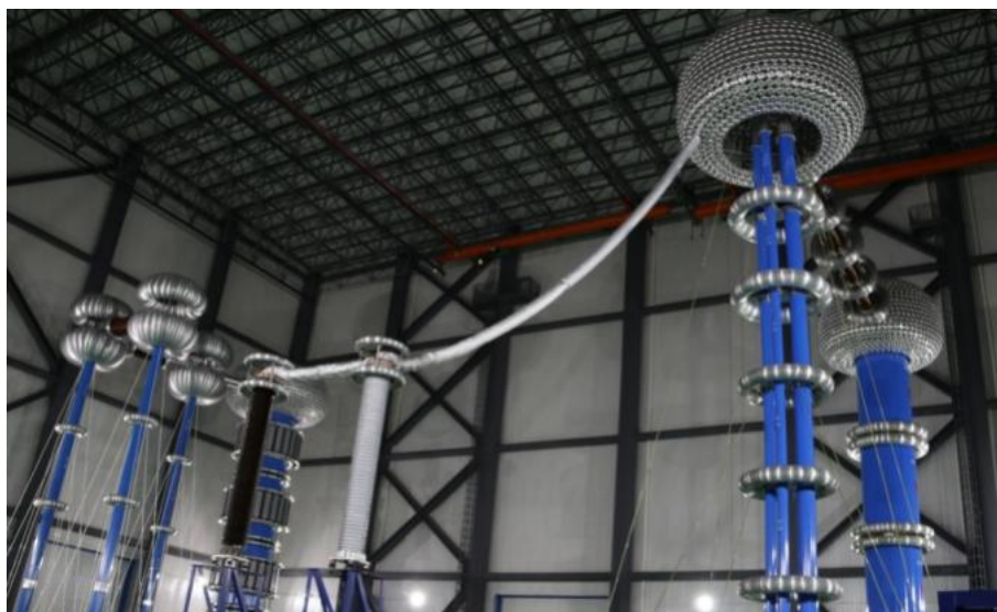
亨通超高压电力测试技术中心
