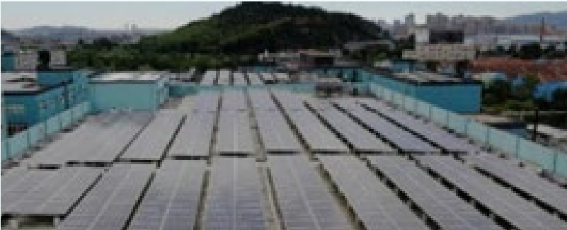
屋顶分布式光伏发电项目
