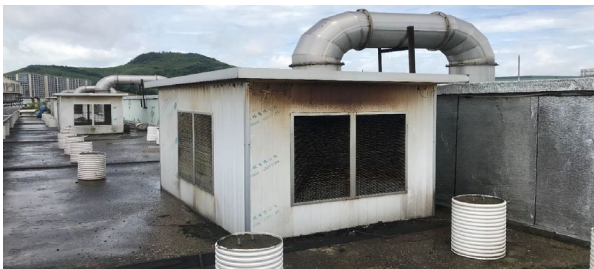
废气处理设施
