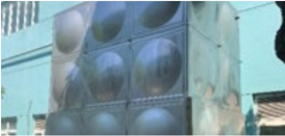
冷冻机组蓄能水箱
