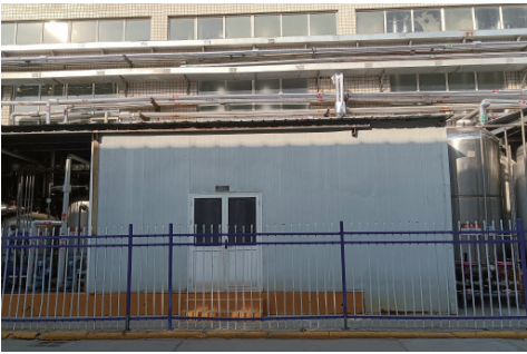
新乡海滨大型设备冰机降噪项目示例图
