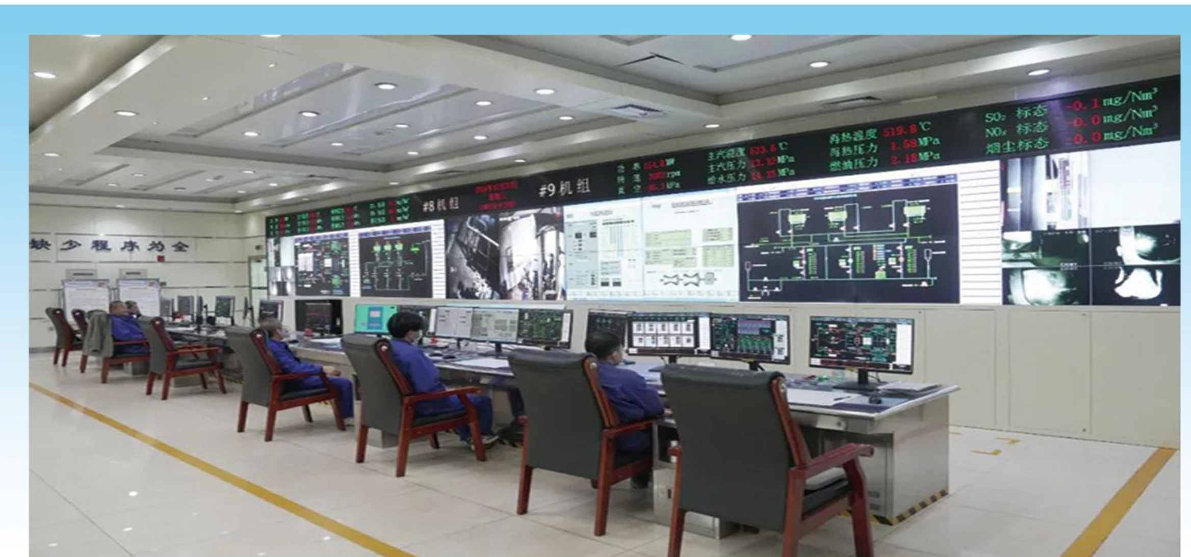
华电能源公司系统首台DCS国产一体化改造机组成功并网投运
