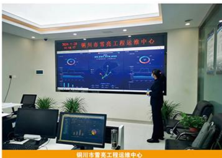
铜川市雪亮工程运维中心
