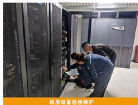
机房设备巡检维护
