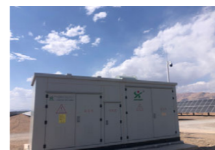
中石化新疆库车 绿氢示范项目
