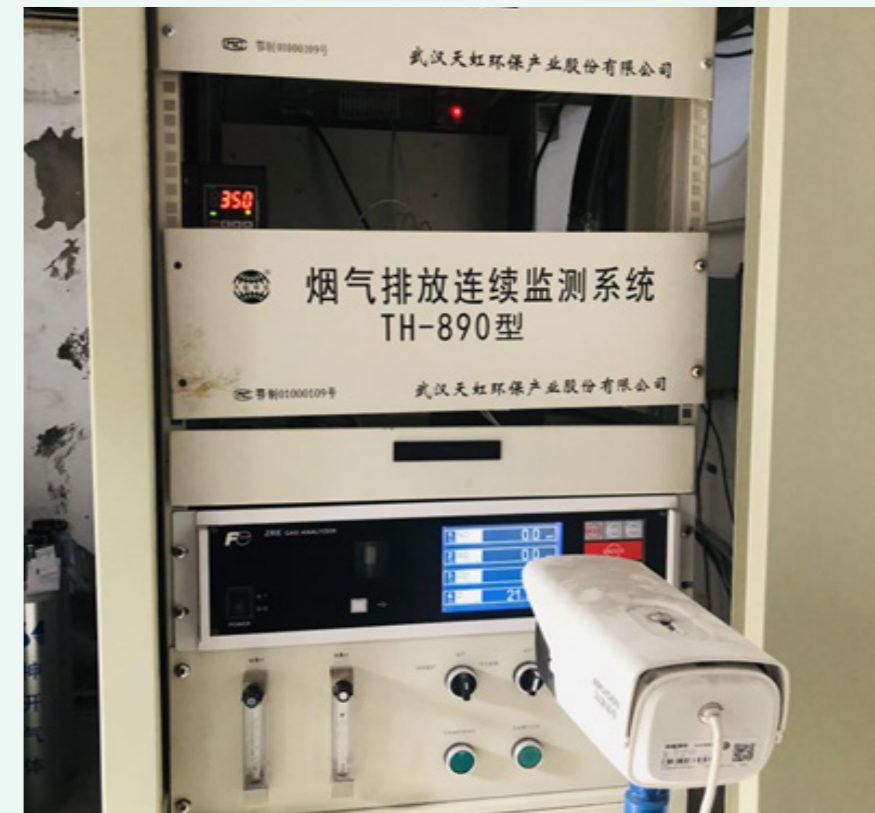
烟气排放连续监测系统
