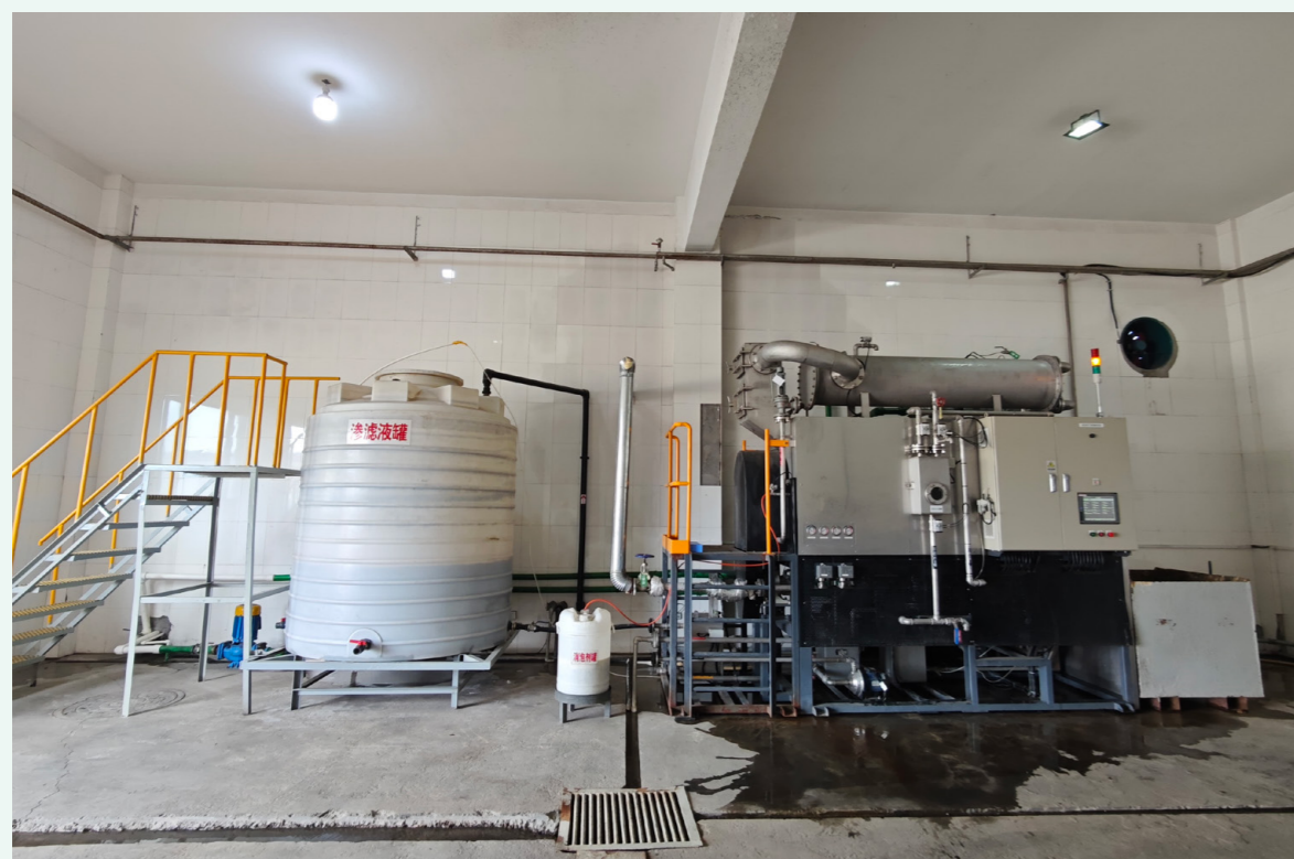
| 城发生态采用节能高效装置 |
