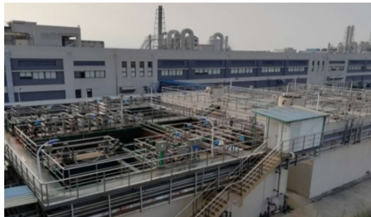
废水处理设施
