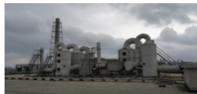
废气处理设施
