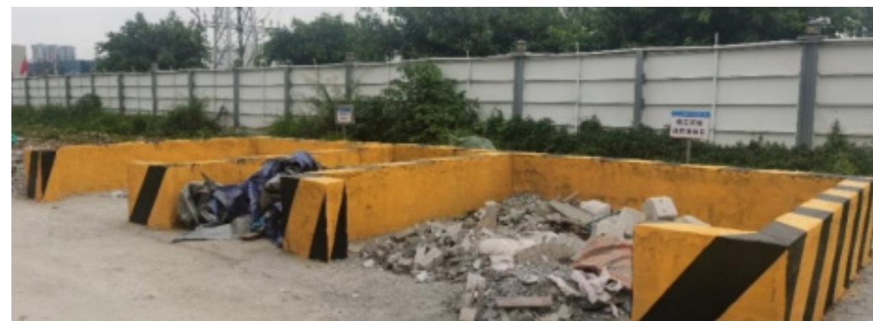
产业园建筑固体废物分类存放池
