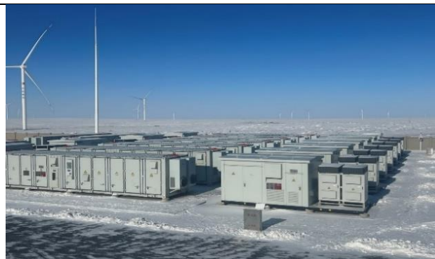
京能内蒙古苏尼特左旗储能电站
