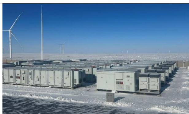
京能内蒙古苏尼特左旗储能电站
