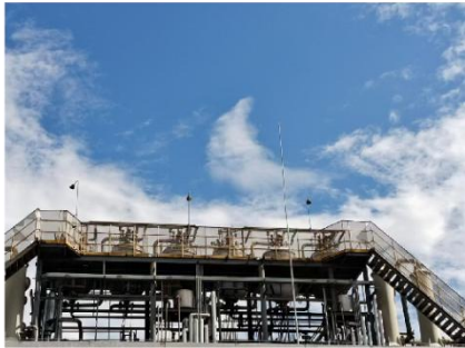
活性炭和碱液废气吸收系统
