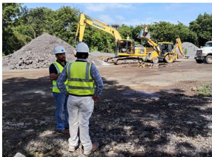
尼加拉瓜蓬塔韦特国际机场项目为当地创造就业机会，并提供技能培训，帮助当地员工掌握先进的工程和管理技术；同时，项目特别关注劳工权益的保护，提供公平的薪酬和工作条件，确保工人的安全与健康。
