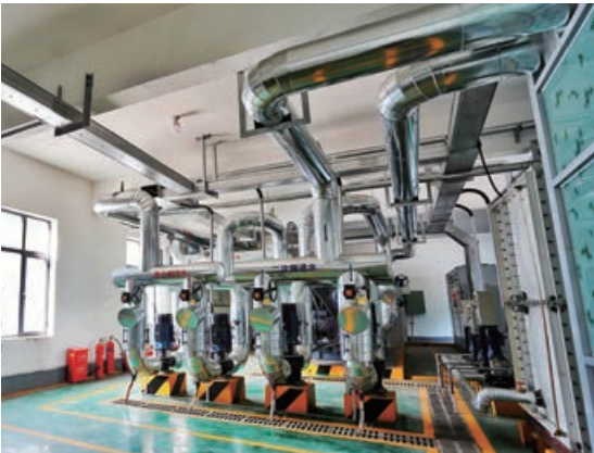
煤层气公司建成国内煤矿区首个中深层地热能供暖项目
