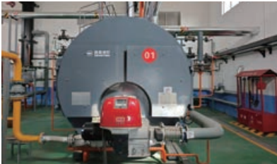
6吨燃气蒸汽锅炉
