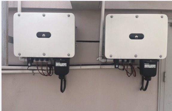
光伏发电转换器
