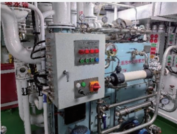
生活污水处理装置
