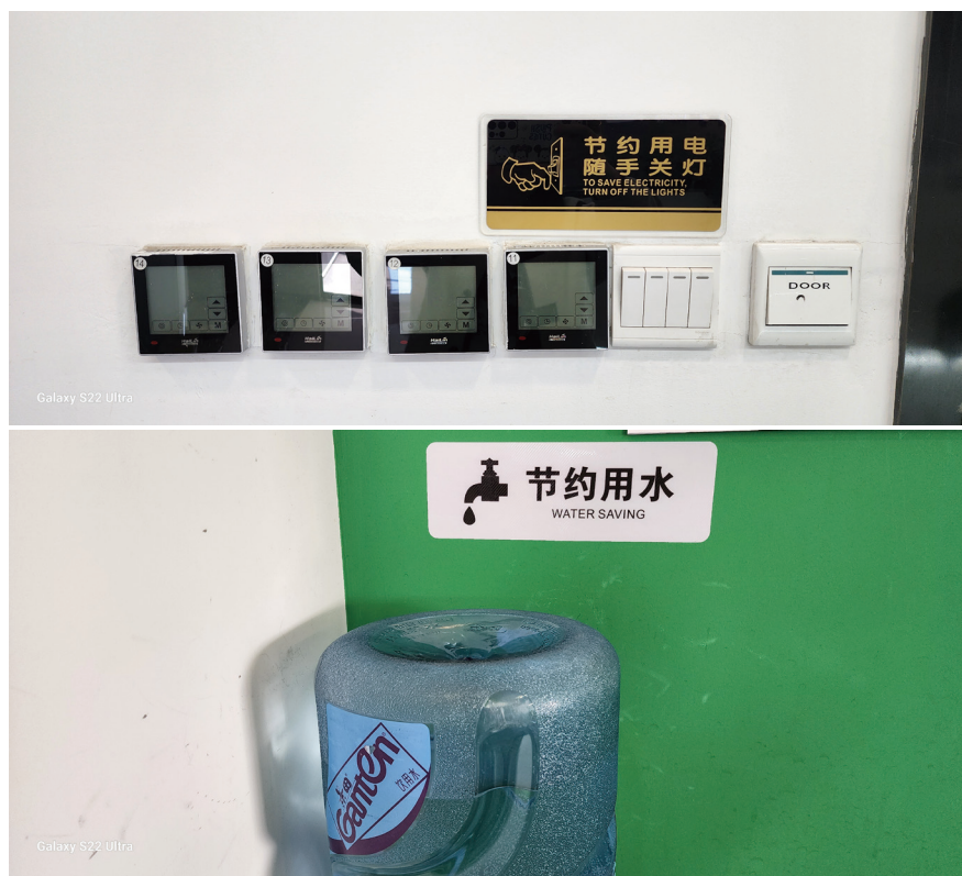
辦公區域內張貼的節電與節水標識
