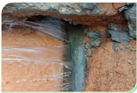
供水管漏水前
