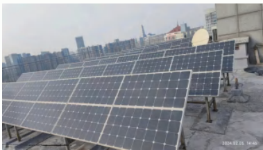
太阳能光伏板
