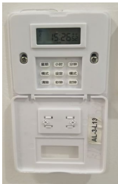
公司上海总部安装节能定时开关
