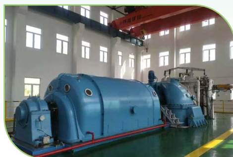
餘熱發電裝置
