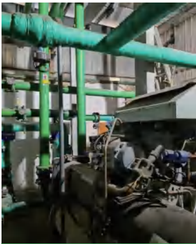
井上华翔水循环设备
