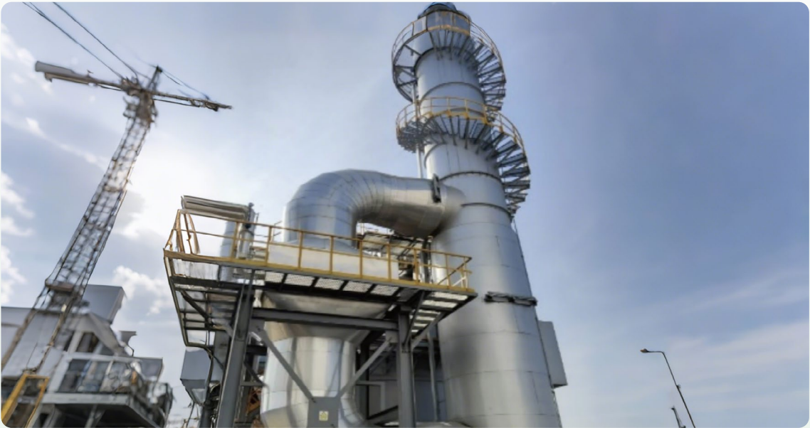
杉金光电（张家港）RTO 废热回收装置
