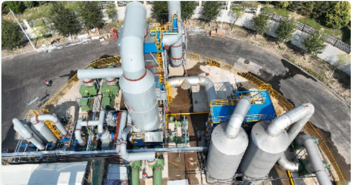
新改造尾气站航拍图
