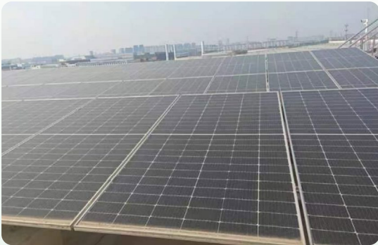
杉金光电（张家港）光伏项目
