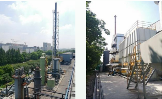
杉杉负极宁波工厂 RTO/TO 废气处理设施
