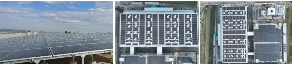
• 岚山厂区光伏设备
