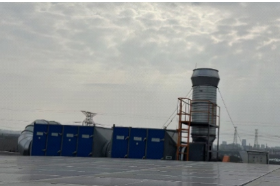
新增两套 废气处理设施
