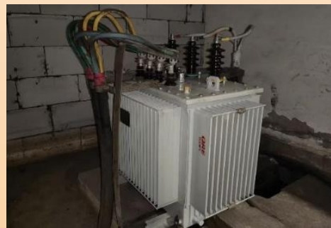
• 更换后的二级能效变压器
