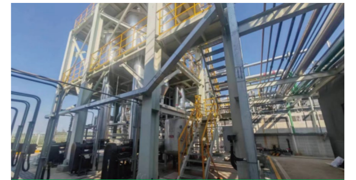
多效蒸发装置
