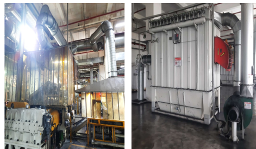
废气收集罩及储尘器
