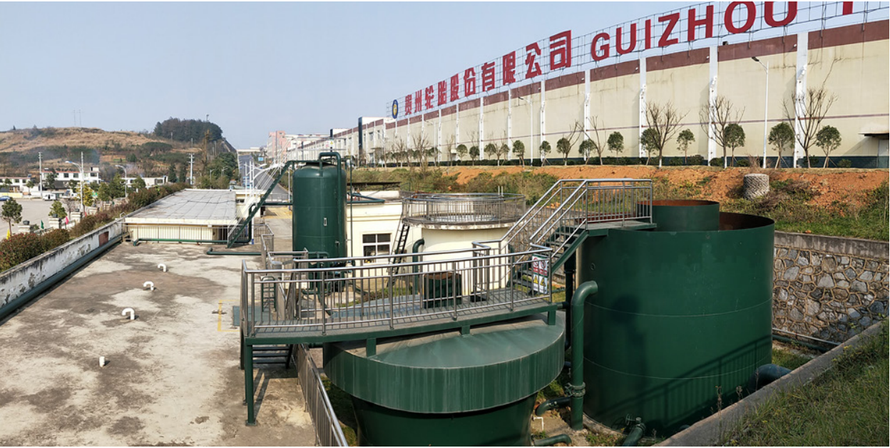
公司污水处理站
