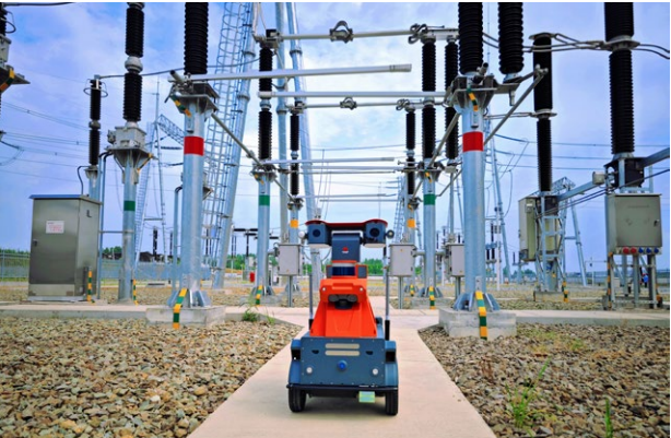
随州公司 5G 升压站机器人智能巡检系统
