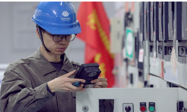
荆门公司做好继电保护，确保电力系统的整体运行安全
