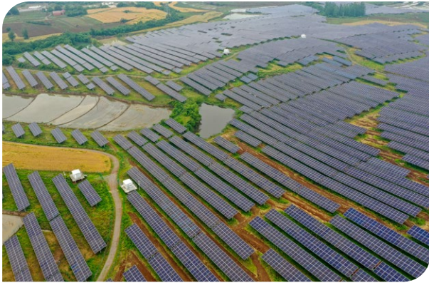
荆门公司钟祥光伏电站
