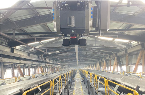
荆州公司“智能巡检机器人”
