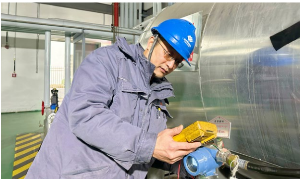
荆州公司加强热控设备维护，让人机交互更顺畅，生产运行更稳定可靠
