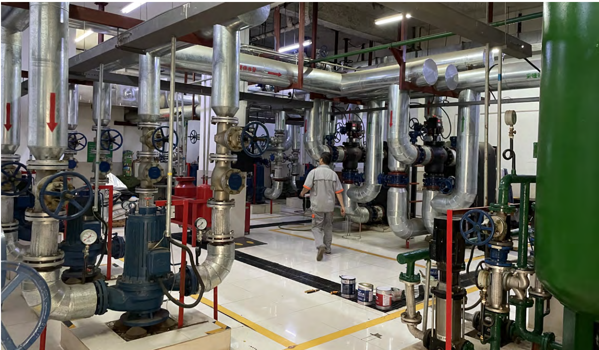
智慧供热项目
