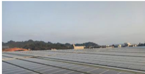
景德镇基地屋顶分布式光伏
