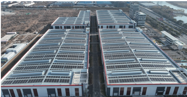
盐城洪田科技有限公司屋顶分布式光伏发电EPC项目
