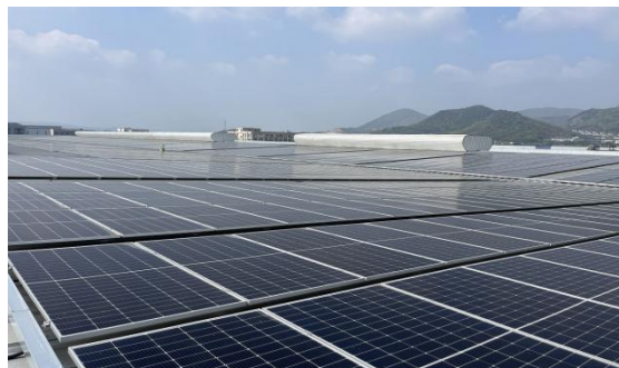
湖州新坐标光伏项目
