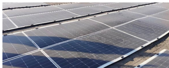
首都國際機場焚燒站屋頂光伏設施
